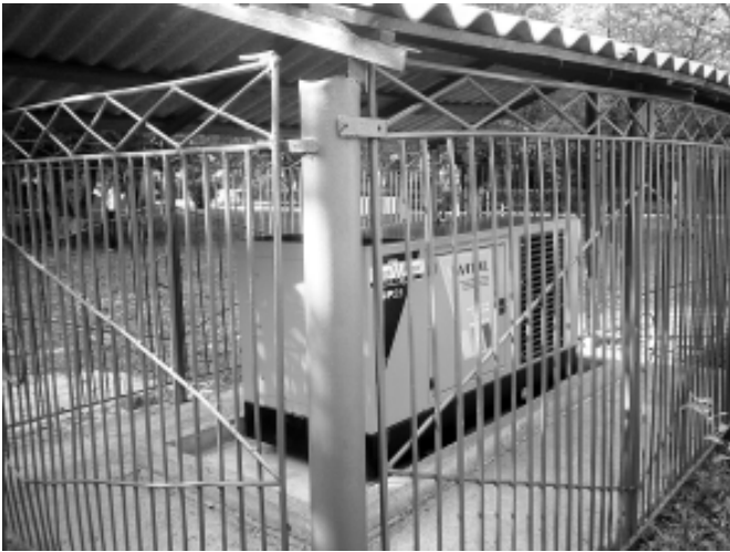
Найпотужніша в області дизель-електростанція у пологовому будинку, 2013 рік.
