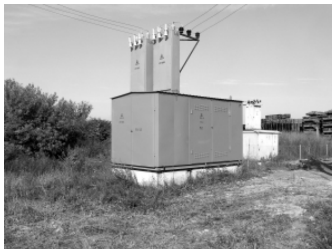
Трансформаторна підстанція на місці смердючої калабані на вулиці Словацького, 2014 рік.
