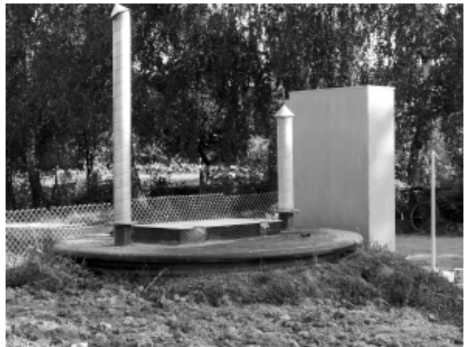
Насосна станція каналізаційного колектора на вулиці Словацького, 2014 рік.
