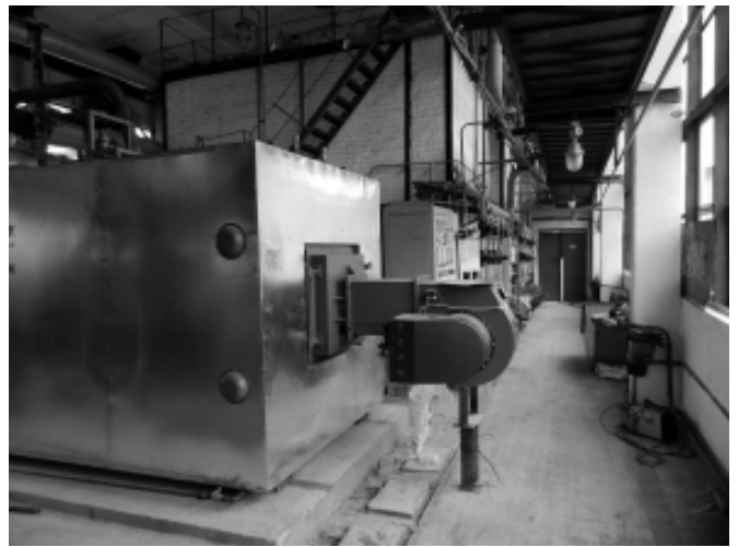
Сучасний енергоефективний котел KB-4,65 у котельні по вулиці Князя Острозького, 2014 рік.
