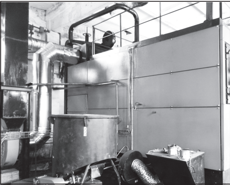
Продовжено реконструкцію котельні на вулиці Грушевського, 170в, де встановлено другий твердопаливний котел
