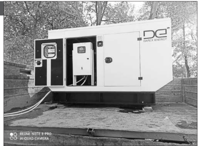
Генератор для забезпечення безперебійного постачання питної води.
