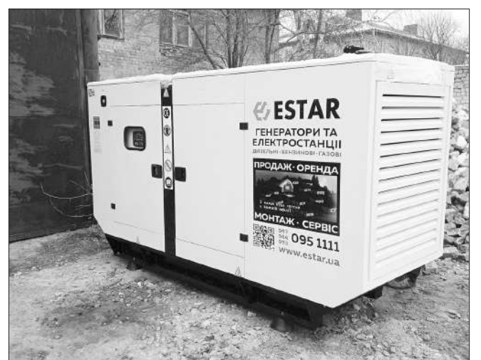
Генератор на котельні вул. Грушевського, 141. Потужністю 180 кВт.
