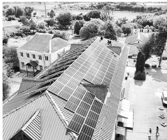
Сонячна електростанція на покрівлі міської лікарні
